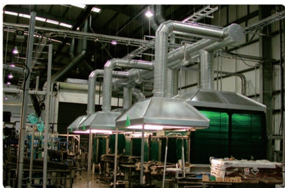
● 製程廢氣抽引
