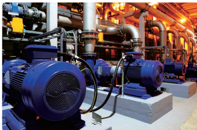
● 高壓設備使用
